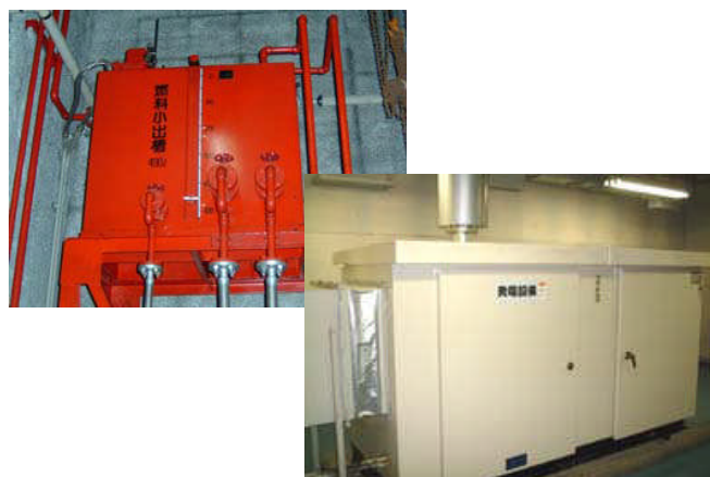
写真3 燃料タンクと発電装置
