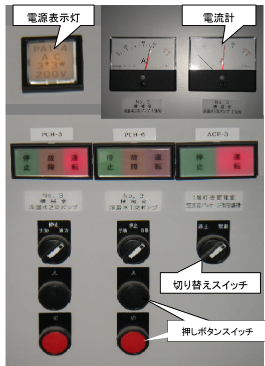
写真1 制御盤表面機器類
