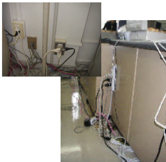
写真4 煩雑となっている配線
